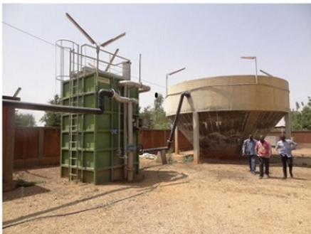
La station de traitement actuelle de l'ONEA à Boromo
