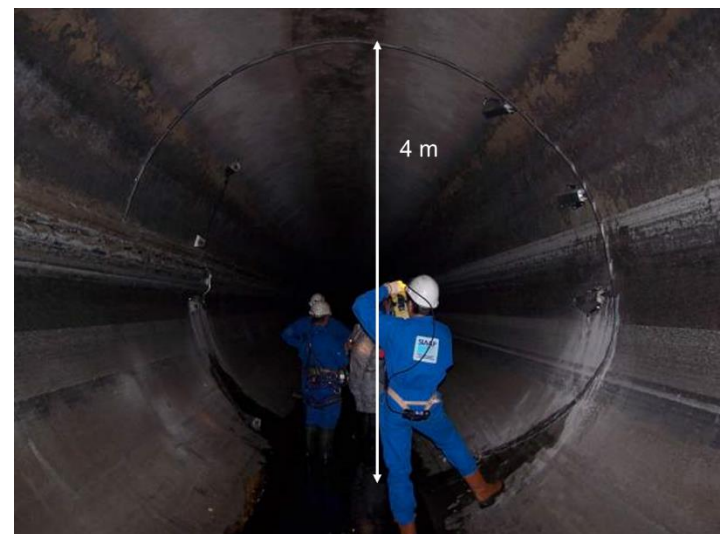
Figura 22. Vista de un emisario (fuente: SIAAP)
